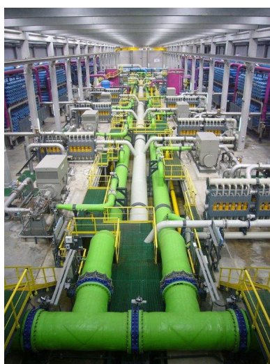
Figuur 5: Ontziltingsinstallatie waarin de breekplaat type SD-RO voornamelijk gebruikt wordt.
