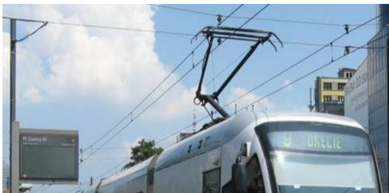
Figuur 9: Bovenleiding en pantograaf
